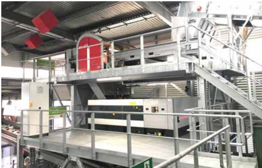
Plastic packaging sorting plant with REDWAVE NIR Kunststoffsortieranlage mit REDWAVE NIR
